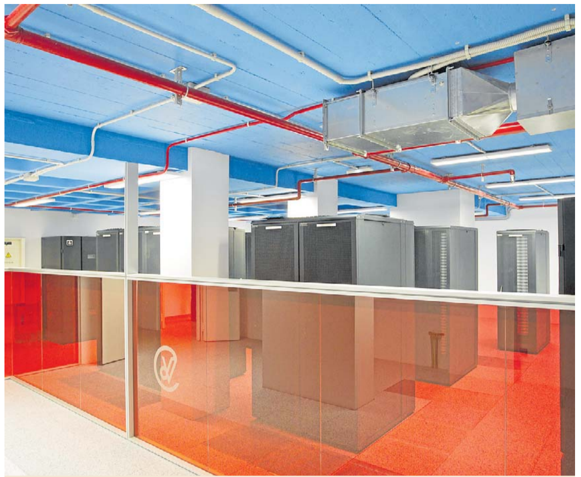
Centro de Proceso de Datos del hospital Valdecilla. JAVIER COTERA
