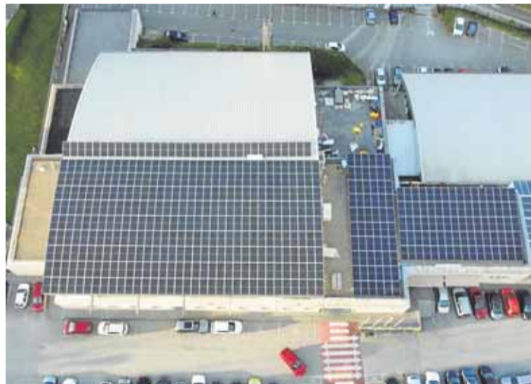
Placas fotovoltaicas en el centro 'Move&Go' de Santander. DM
