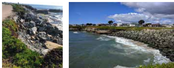
Problemas de erosión en Santa Cruz, invierno 2022 (izquierda), protección costera para evitar la erosión del acantilado y la carretera (derecha).
