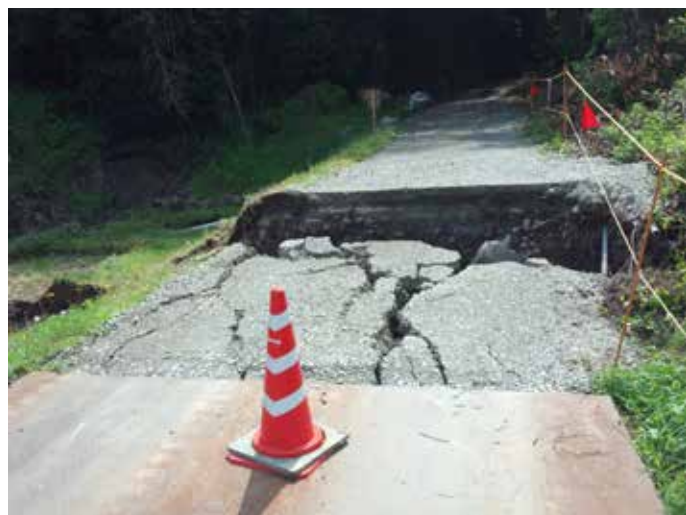
Efecto de la licuefacción de las arenas que ocupan el valle.
