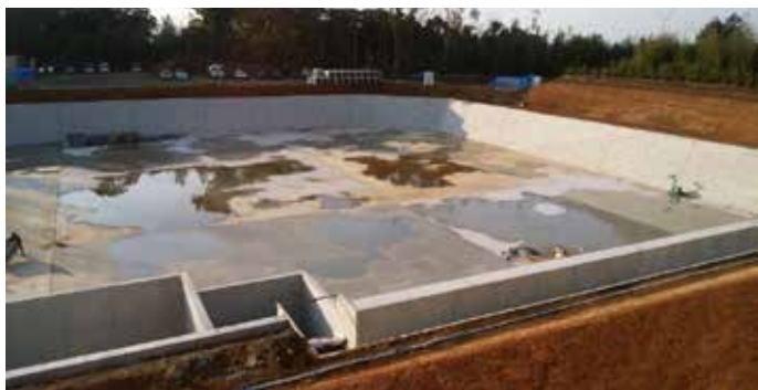
Balsa de retención nº 2 (Mashiki). Las dimensiones se aprecian observando los vehículos al fondo
