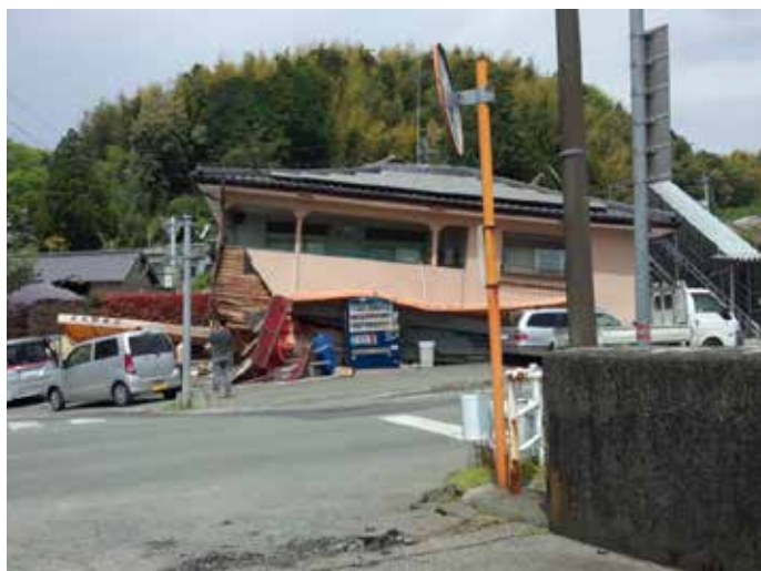
Pasaba cada día junto a esta casa. Así quedó tras el terremoto
