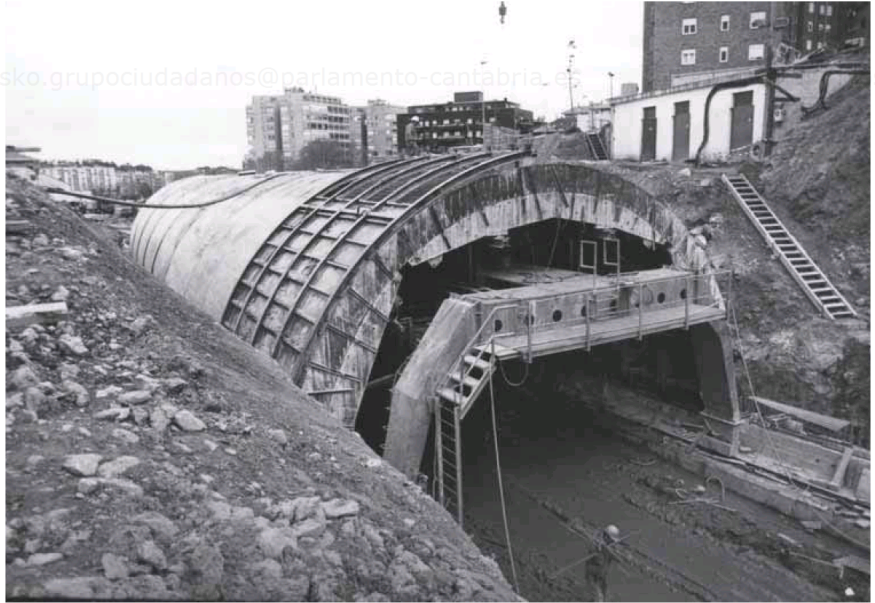
Las obras comenzaron en el verano de 1989 y finalizaron en la primavera de 1991. DM
