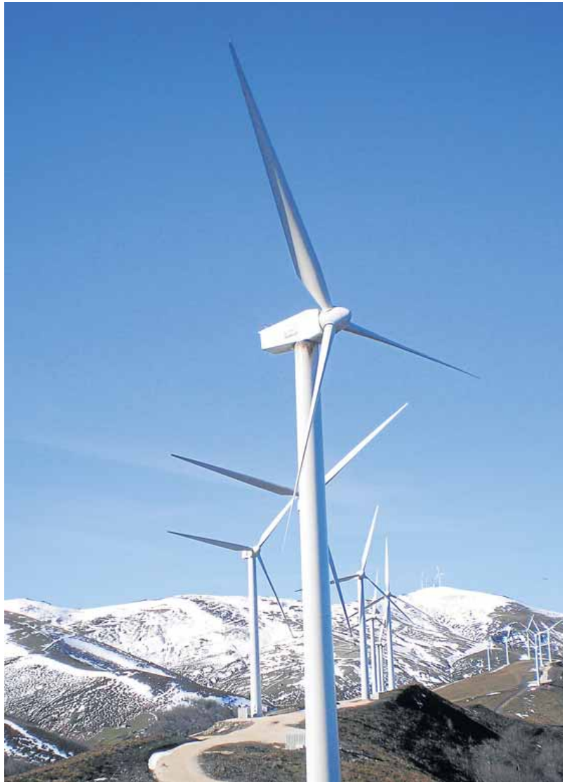
Soba. Aerogeneradores del parque de Cañoneras.
